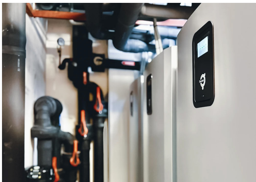
Tri tepelná čerpadla Mega L v technické místnosti
