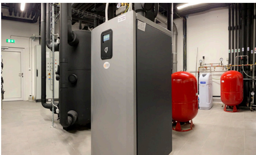
Technická místnost s Thermia Mega
